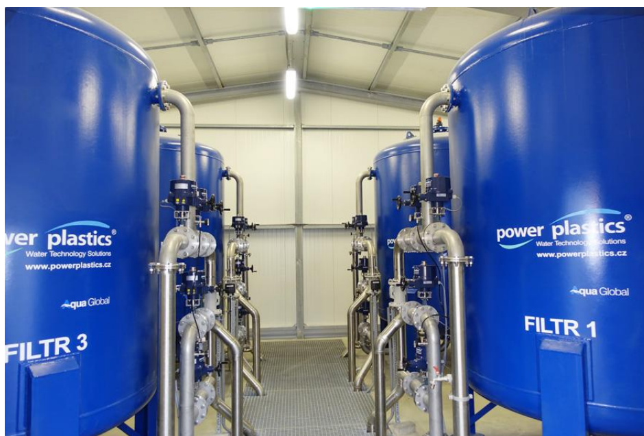
Obr. 9 Tlakový filtr s GAU pro doúpravu pitné vody [25]
