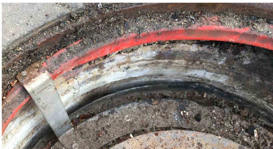
Obr. 4.20 Detail nedoléhajícího těsnění
