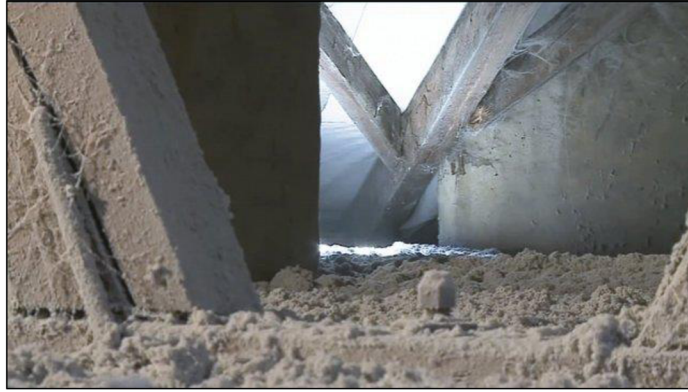
Obr. č. 22 - Celulózná tepelná izolace je aplikována foukáním, lze jí vyplnit jakékoli, i obtížně dostupné dutiny (foto CIUR) [8]
