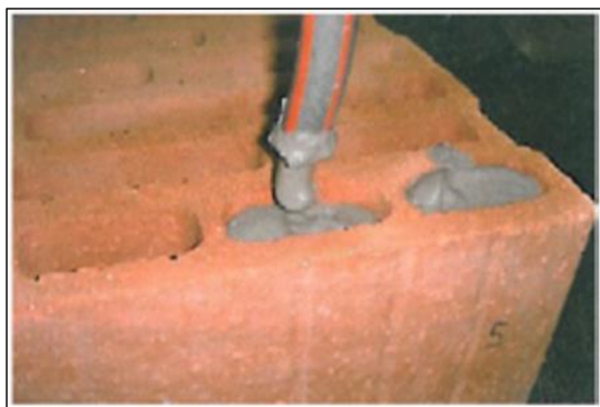
Obr. č. 26 - Vyplňování dutin izolačním materiálem na silikátové bázi, součinitel tepelné vodivosti \lambda \leq 0,045 \text{ W/(m}\cdot\text{K)} [49]
