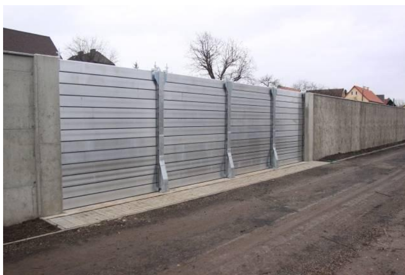
Obrázek č. 8, Mobilní protipovodňová ochrana v místech přístupů na pozemky, http://www.hgpartner.cz/images/aktuality/a01.jpg
