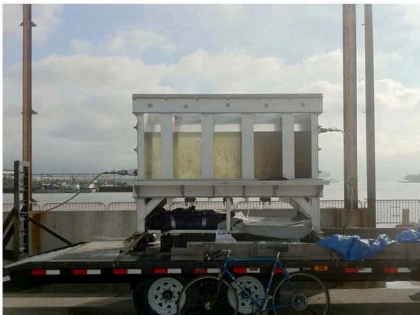
Filtrační membrány byly osazeny do nádrže. Do její pravé části je přiváděna voda z řeky, směrem k levé části dochází skrz membrány k jejímu čištění
