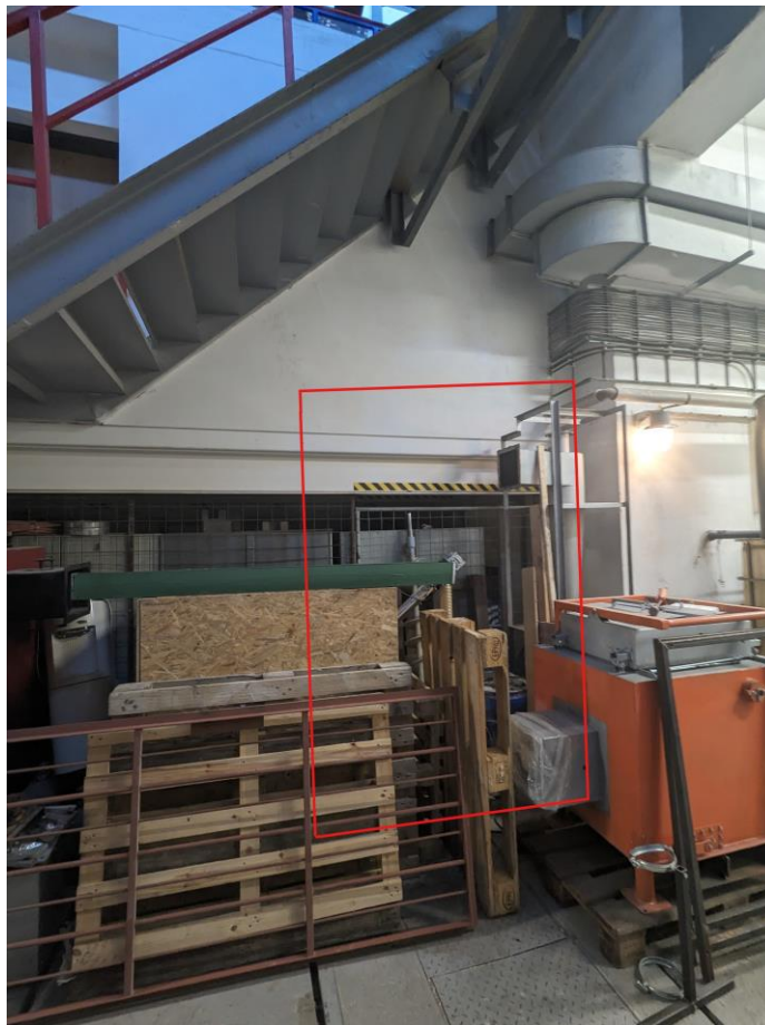
Obrázek 4.1 Umístění akumulátoru v budově C3 (červená oblast)
