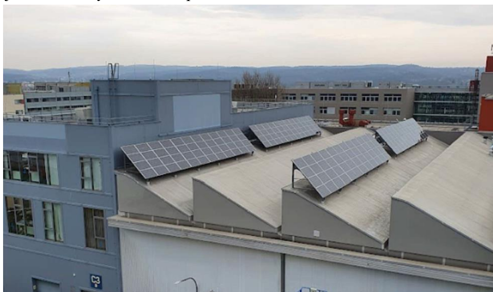
Obrázek 3.3 FVE na střeše budovy C3
