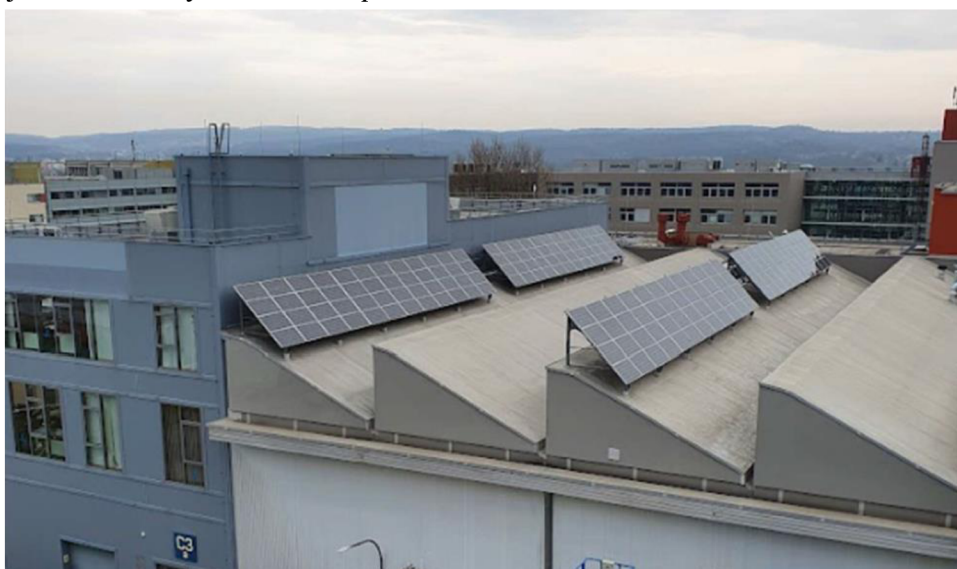
Obrázek 3.3 FVE na střeše budovy C3
