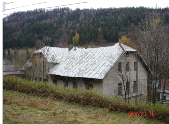
Obr. 29: Pohled na propadlou střechu penzionu
