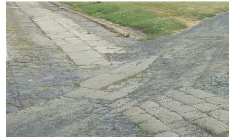
obr. 83. špatný technický stav materiálů
