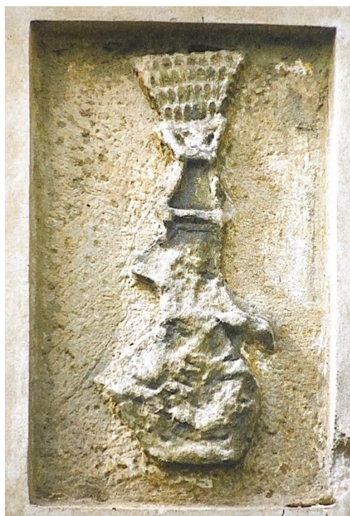
[9] Poškozená erbovní deska v jižním průčelí lodi kostela Nanebevzetí Panny Marie v Chotěborkách
