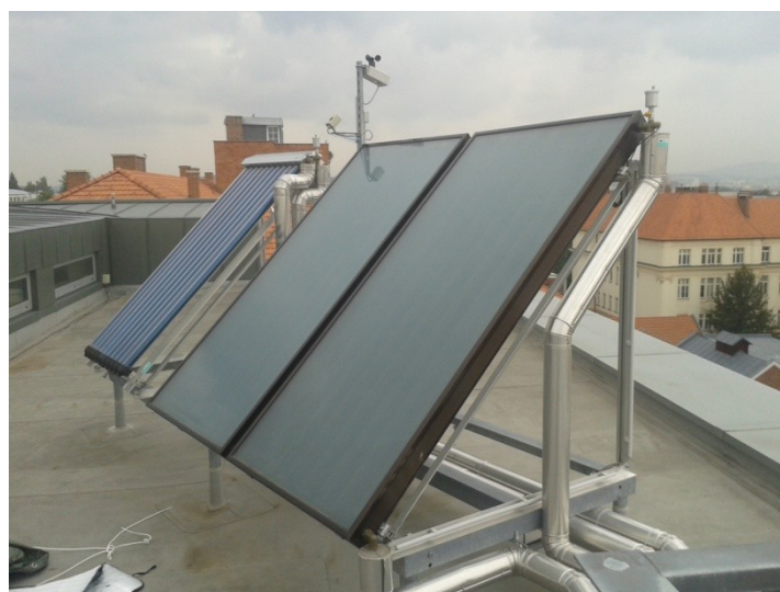
Obr. 3.2 Kolektory umístěné na střeše objektu E
