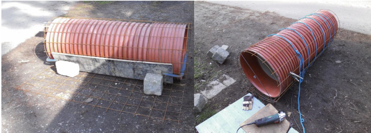
Obr.5.16 vlevo zkružení rotoru před svařením švu, vpravo rotor po navaření středového žebra, před vytažením z kopyta.
