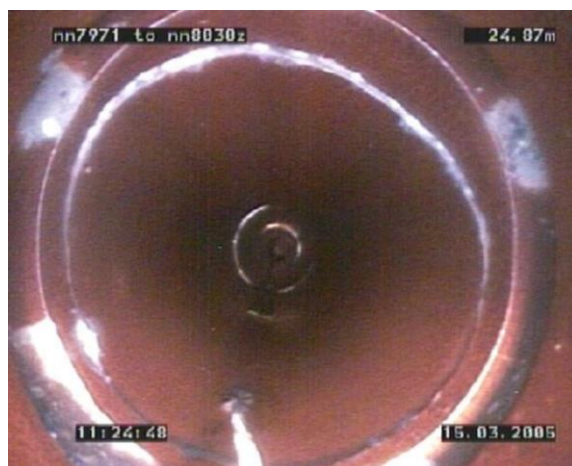
Obr. 15 Spirálová trhlina, osové vybočení potrubí [33]
