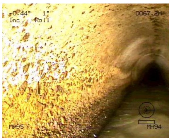
Obr. 16 Koroze ocelového potrubí [33]
