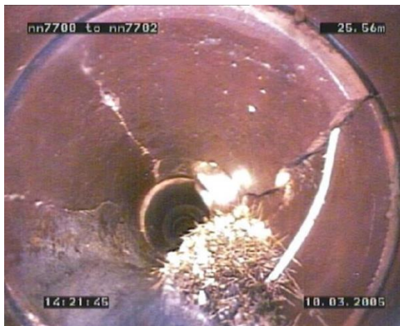
Obr. 10 Podélné trhliny, zlom horní částí potrubí, kořeny [33]
