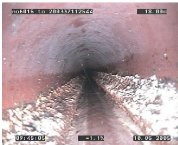
Obr. 14 Usazeniny v potrubí [33]
