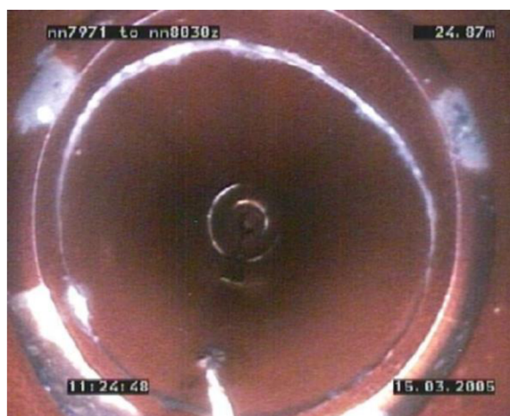
Obr. 15 Spirálová trhlina, osové vybočení potrubí [33]
