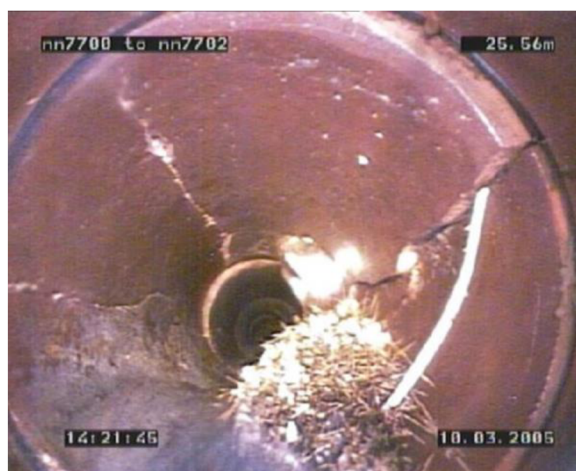
Obr. 10 Podélné trhliny, zlom horní částí potrubí, kořeny [33]
