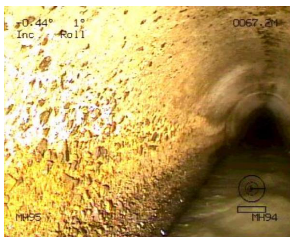
Obr. 16 Koroze ocelového potrubí [33]
