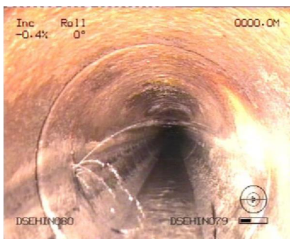
Obr. 17 Infiltrace, biogenní síranová koroze [33]
