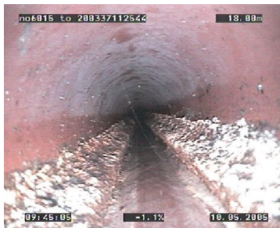
Obr. 14 Usazeniny v potrubí [33]
