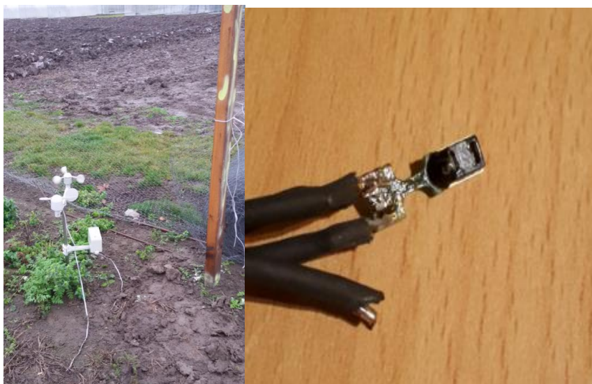
Obr. 67. Přerýznutý drát u anemometru (vlevo), chybný kontakt u kombinovaného teplotního a vlhkostního senzoru (vpravo), zdroj: vlastní fotografie
