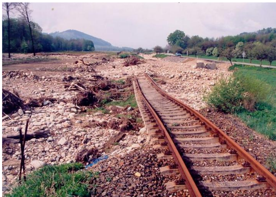
Poškozená železniční trať mezi obcemi Velké Losiny a Loučná nad Desnou.
