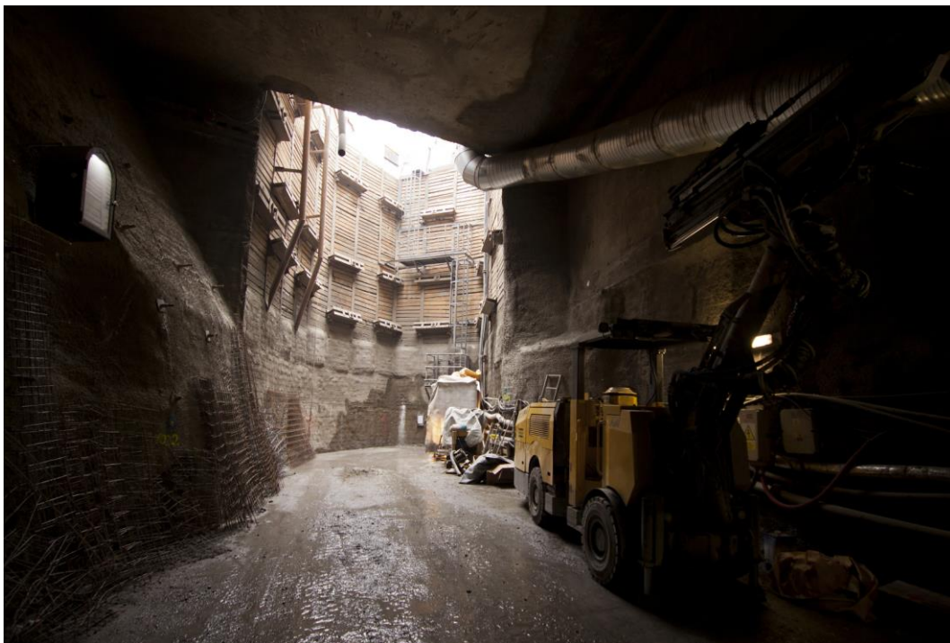
Fotografie č. 7 – Pohled z hloubené části štoly směrem k hloubené jámě vstupní šachty
