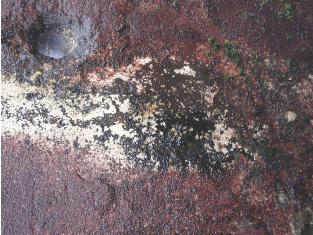
Obr. 10: Červené zbarvení biofilmu způsobené rodem Gloeocapsa
