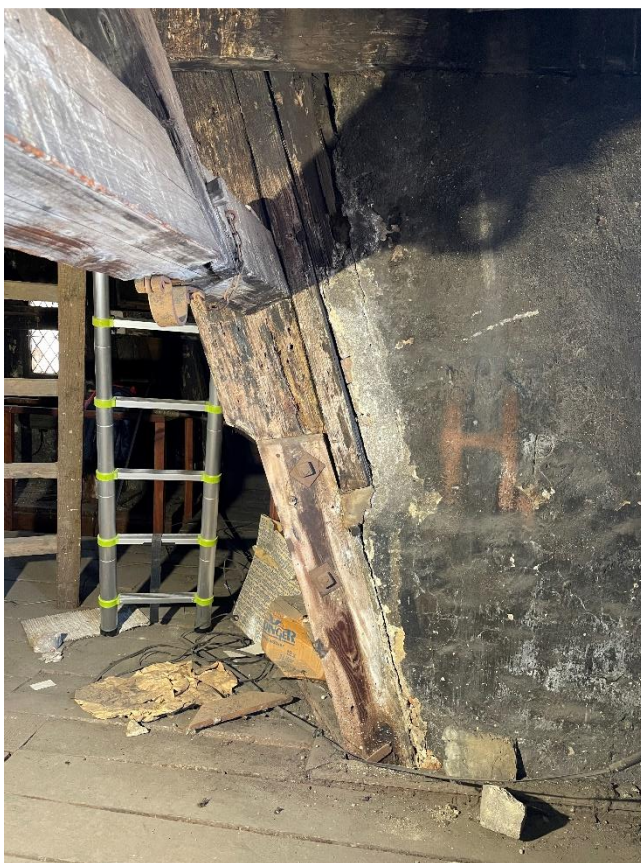
Obrázek 1.9: Pohled na protězu šikmého sloupku a neodborně opravenou a podezděnou krokev vazby VII (1. úroveň, východ).
