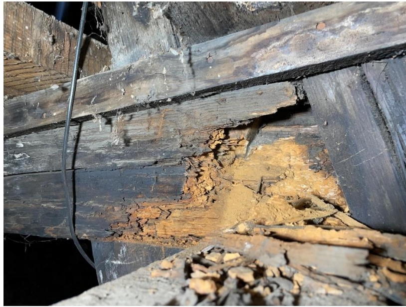
Obrázek 3.9.1: Detail poškození měřeného prvku (hambalek 1. úrovně vazby VII, západ).
