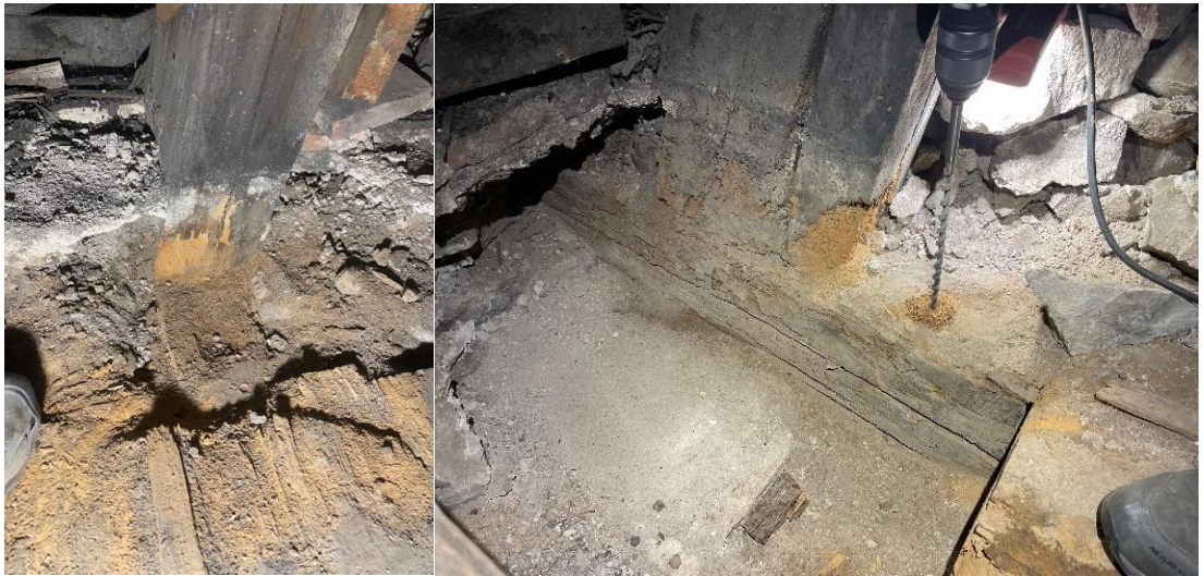
Obrázky 3.5.1 a 3.5.2: Celkový pohled na vyšetřované zhlaví krátčete (vlevo), zhotovení vrtané sondy pro endoskop (vpravo).
