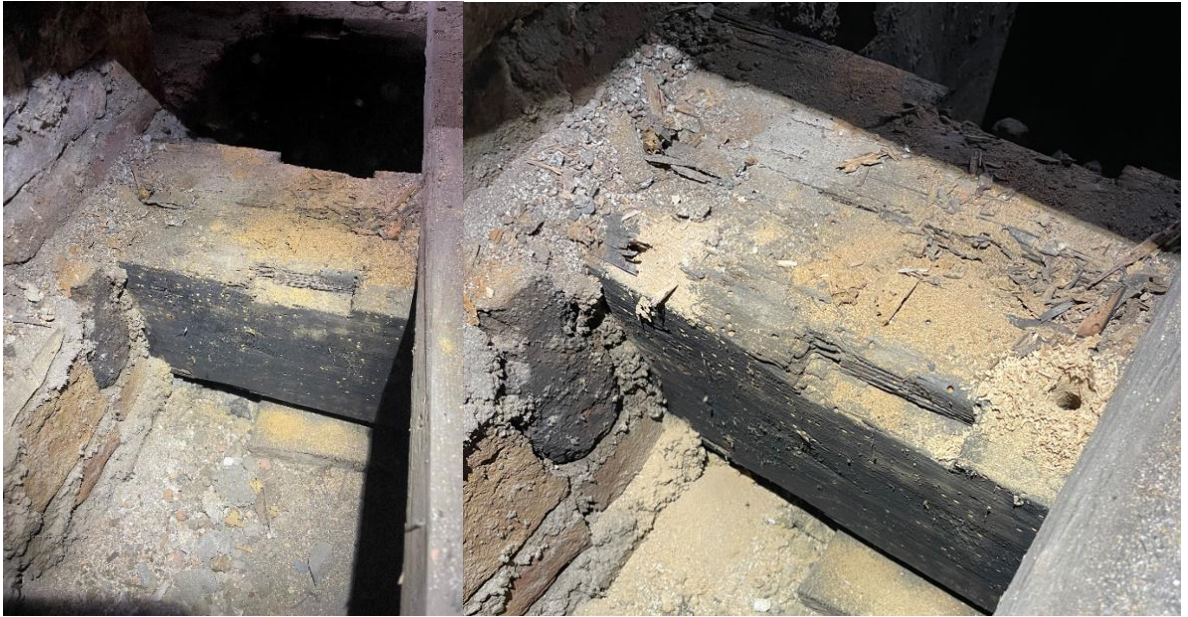
Obrázky 3.4.1 a 3.4.2: Celkový pohled na vyšetřované zhlaví stropního trámu (vlevo), zhotovení vrtané sondy pro endoskop (vpravo). Krátké zhlaví (cca 150 mm) je silně poškozené. Druhý vrt proveden ve vzdálenosti 200 mm od líce zdi (viz obrázek 3.4.2).
