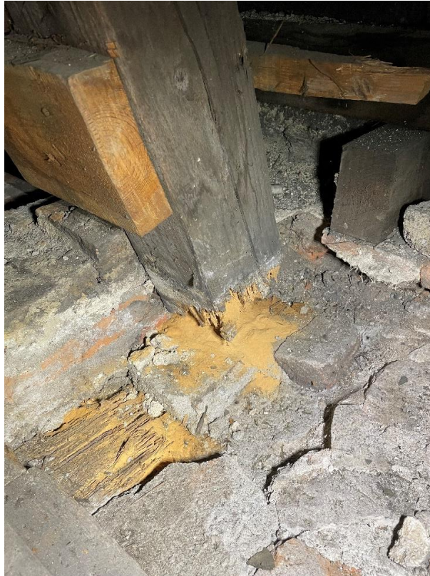
Obrázek 1.13: Detail patní části nárožní krokve vazby III, uložené na zdivo. Zhlaví nového stropního trámu je zkrácené a kapsa po původním trámu je zazděná. Oba prvky jsou napadeny dřevokaznými škůdci (1. úroveň, východ).
