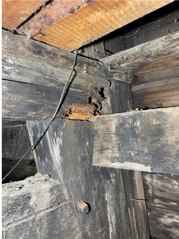
Obrázek 1.14: Pohled na spojení prvků ležaté stolice plné vazby VII v okolí vaznice (1. úroveň, západ). Zhlaví hambalku poškozeno hnilobou.
