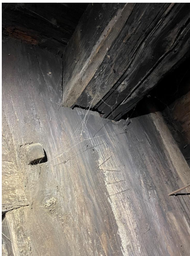
Obrázek 1.16: Čepový spoj ležatého sloupku a vaznice (vpravo nahoře). Plná vazba VII, 1. úroveň, západ.
