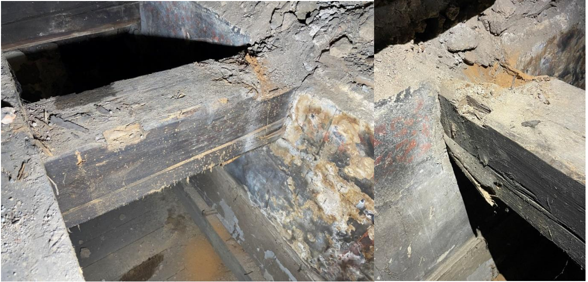
Obrázky 3.7.1 a 3.7.2: Celkový pohled na měřený prvek, měření endoskopem nebylo provedeno. Na základě vizuálního průzkumu je zřejmé, že zhlaví je zcela zničeno.
