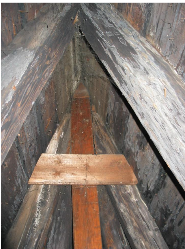
Obrázek 1.24: Detail neodborného spojení nové hrotnice s krokvi ve sběžišti (4. úroveň, jih).
