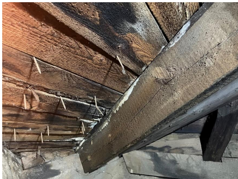
Obrázek 5.1.1.2: Šíření plísní na spodní ploše bednění jihovýchodního námětku z důvodu zatékání.
