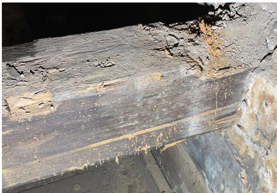
Obrázek 5.1.1.4: Poškození stropního trámu způsobené symbiotickým působením dřevokazné houby a červotoče.
