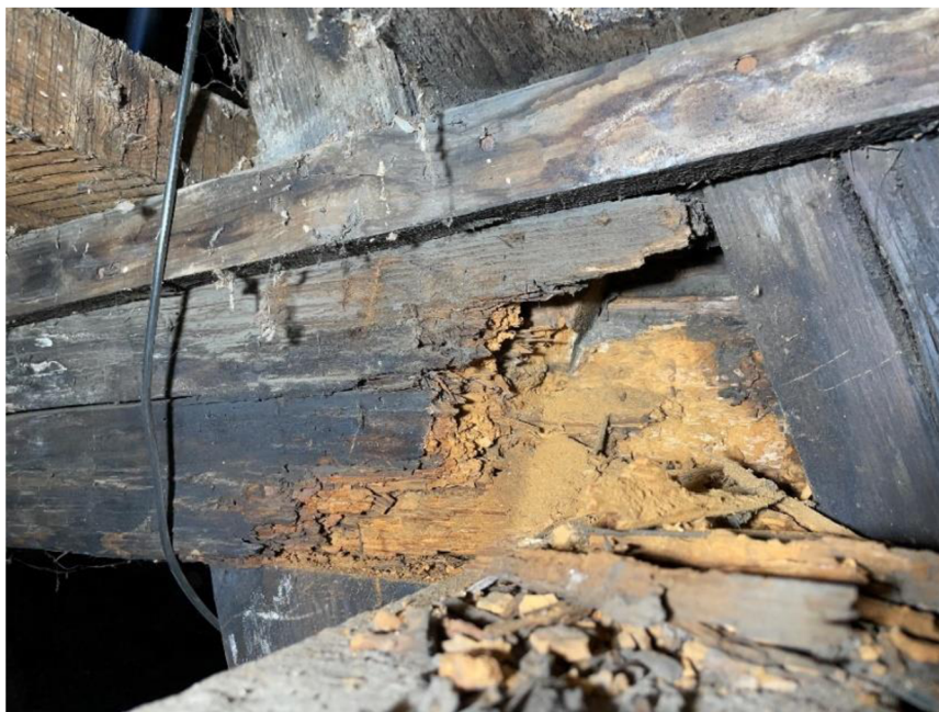
Obrázek 5.1.1.7: Zhlaví hambalku vazby VII (1.úroveň, západ) významně poškozené hnilobou.
