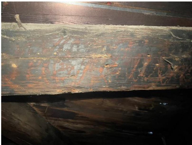
Obrázek 5.1.1.5: Výletové otvory tesaříka krovového.
