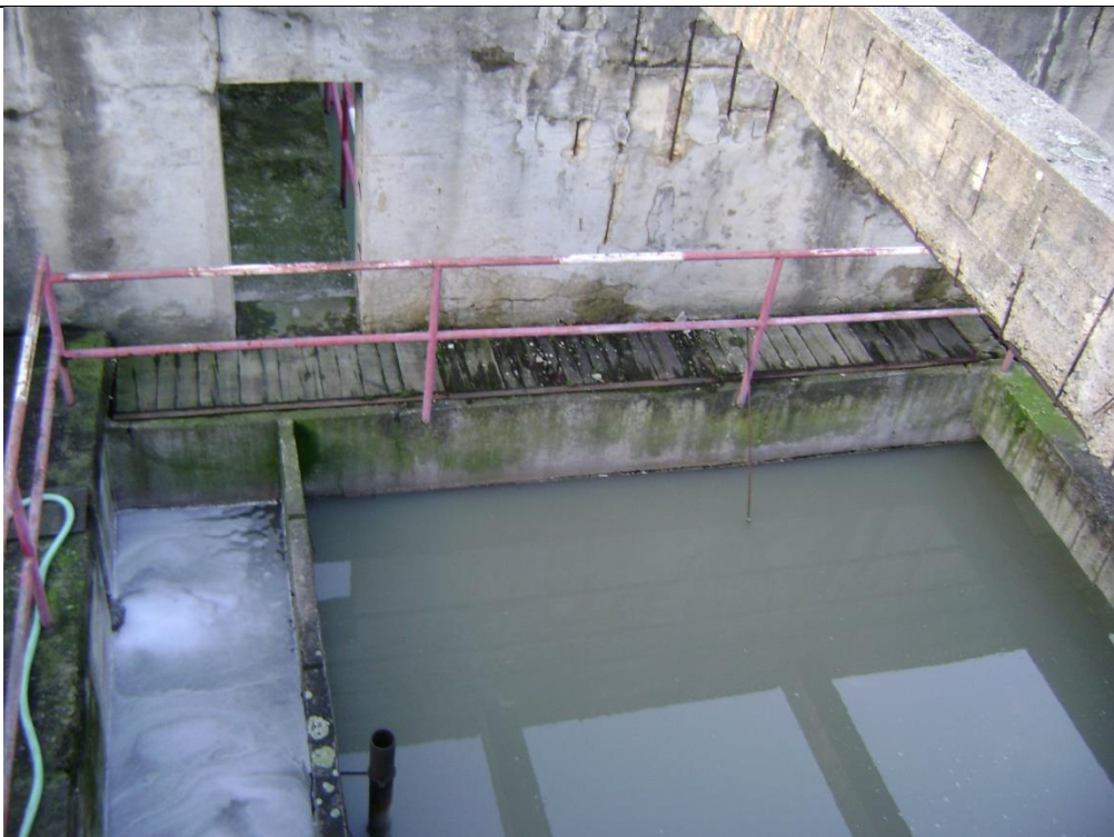
ČOV Bukov – na snímku je vidět již havarijný stav čistírny, která potřebuje provést opravy
