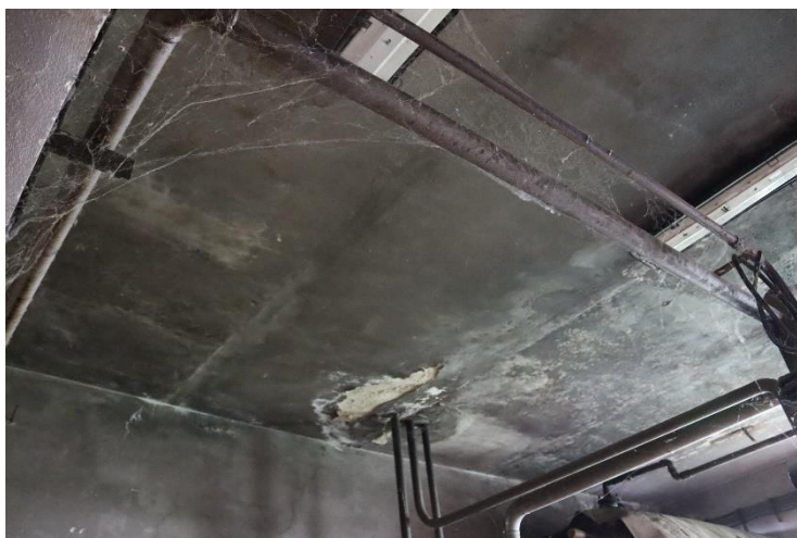
Obrázok 13 - Poškodená omietka okolo rozvodov
