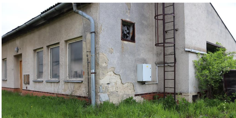
Obrázok 12- Poškodená vonkajšia omietka
