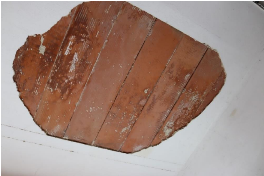
Obrázok 7 - Poškodená stropná doska HURDIS
