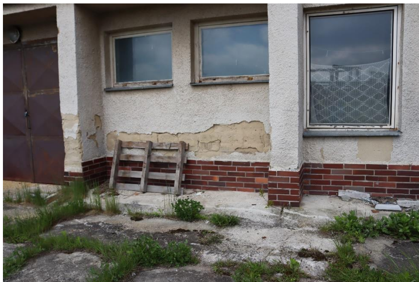
Obrázok 11 - Poškodená vonkajšia omietka
