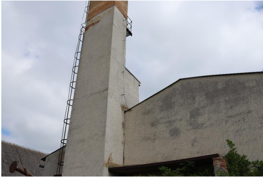
Obrázok 14 - Stav komína, korodované klampiarske prvky, tmavé flaky na fasáde
