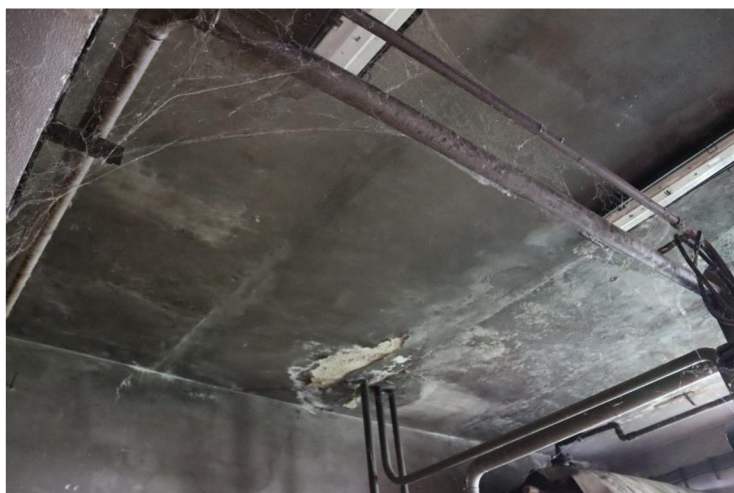
Obrázok 13 - Poškodená omietka okolo rozvodov
