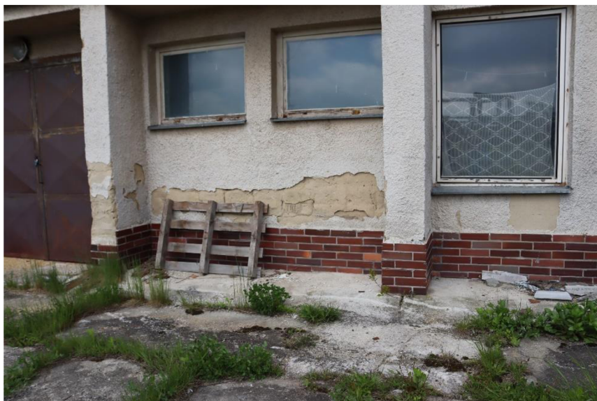
Obrázok 11 - Poškodená vonkajšia omietka
