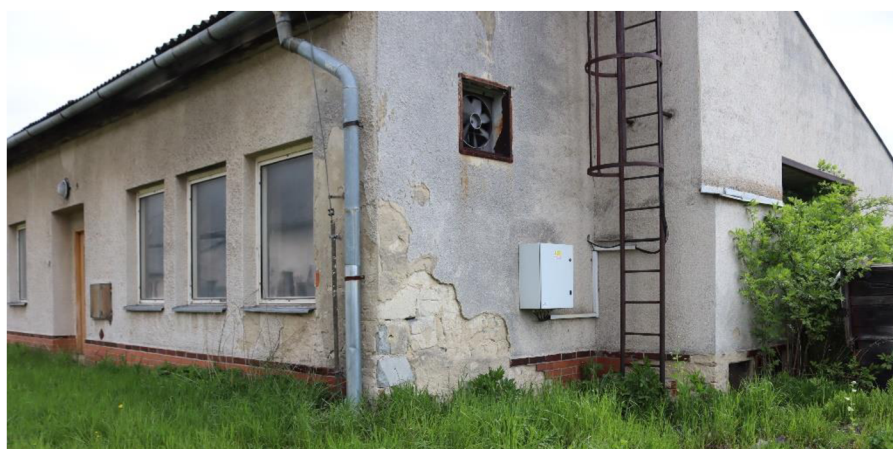
Obrázok 12- Poškodená vonkajšia omietka
