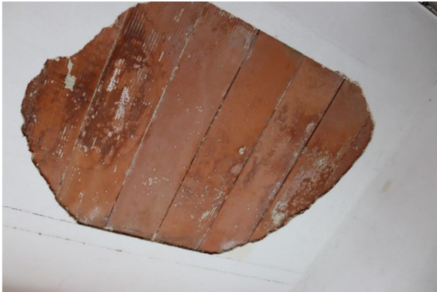
Obrázok 7 - Poškodená stropná doska HURDIS
