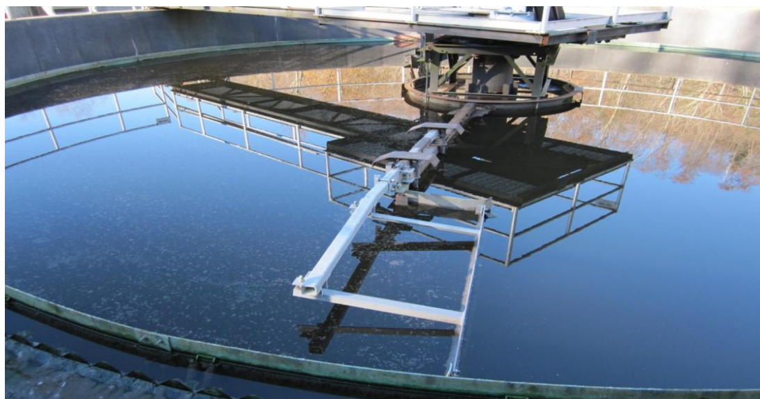
Obrázek č. 2 Dosazovací nádrž v ČOV, kde probíhá separace aktivovaného kalu
