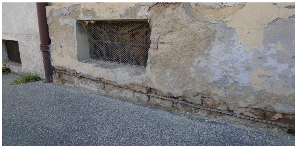
Obr. 4 - následek zemní vlhkosti
