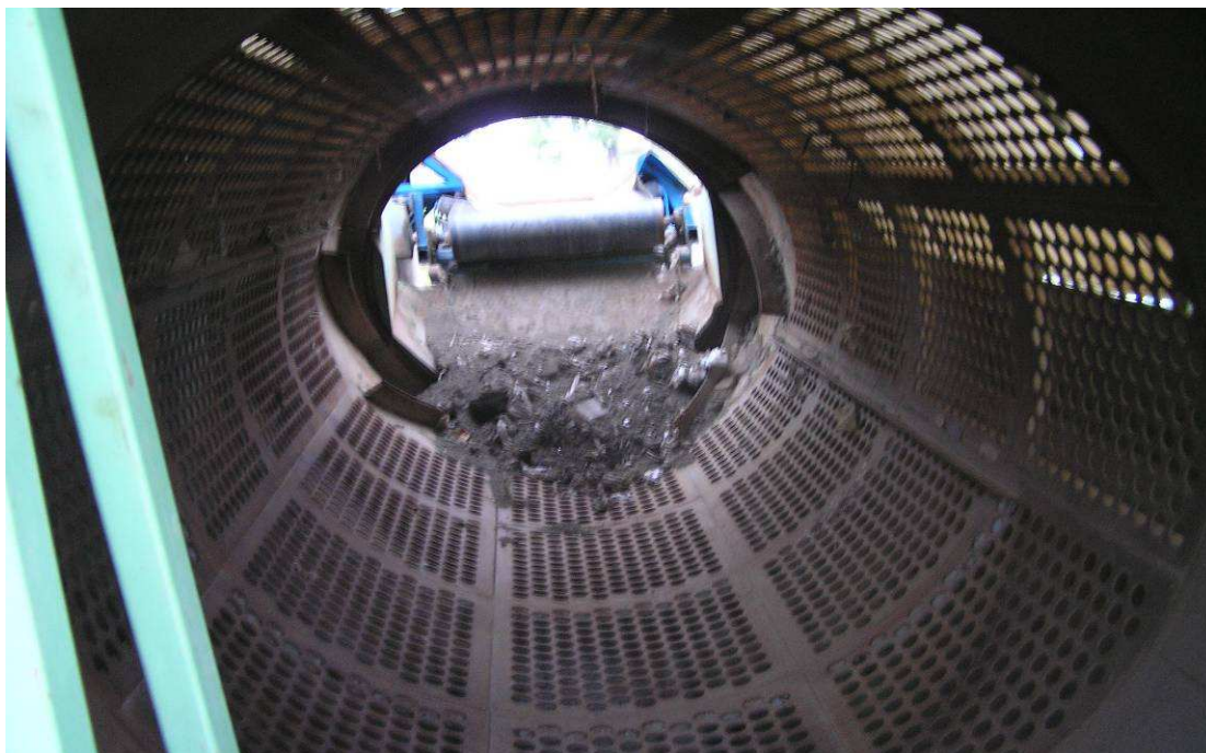
Obr. 12 Třídící linka Příbyšice - pohled na vnitřek bubnového síta
