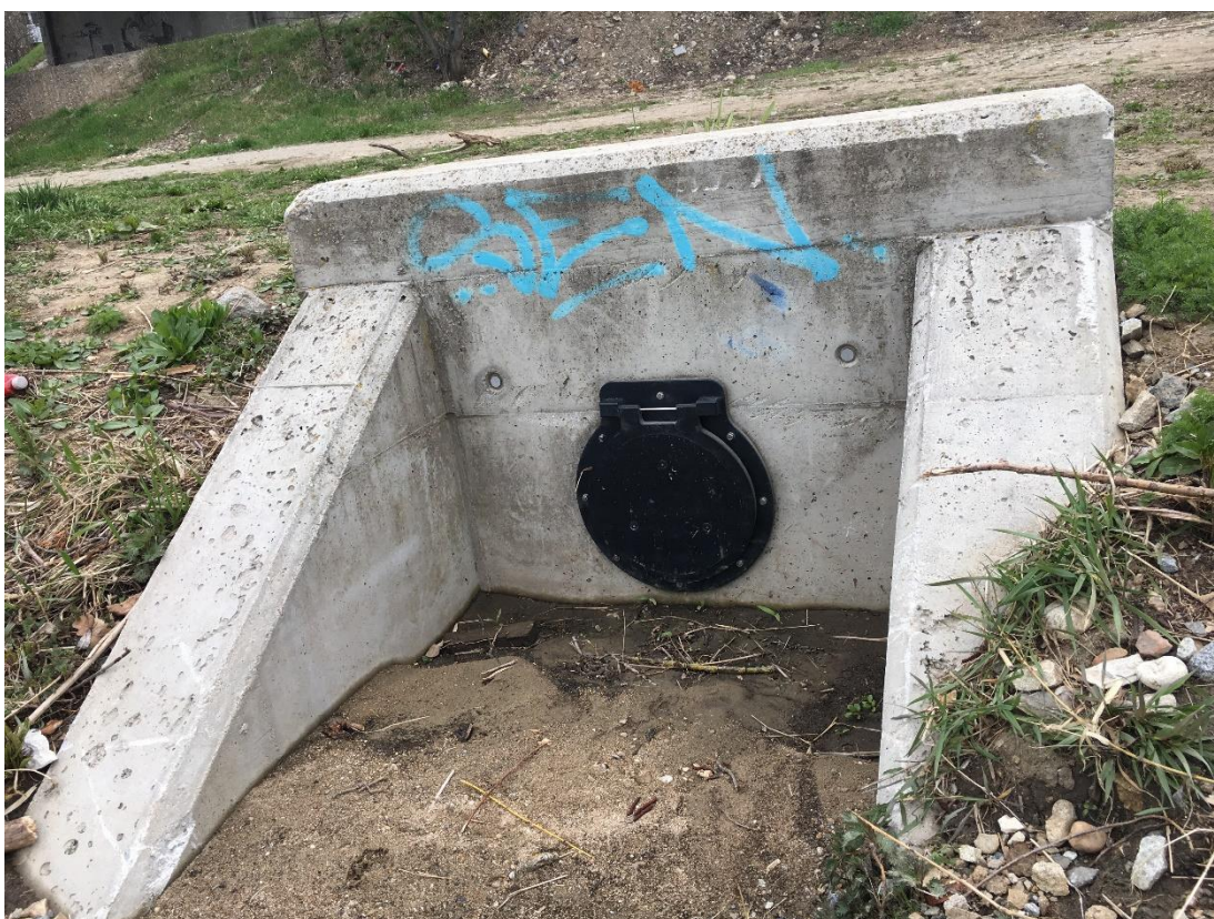
Příloha 9 k textu na str. 26 – SO 11 Zpětné klapky na kanalizaci (Hájková, 2019)
