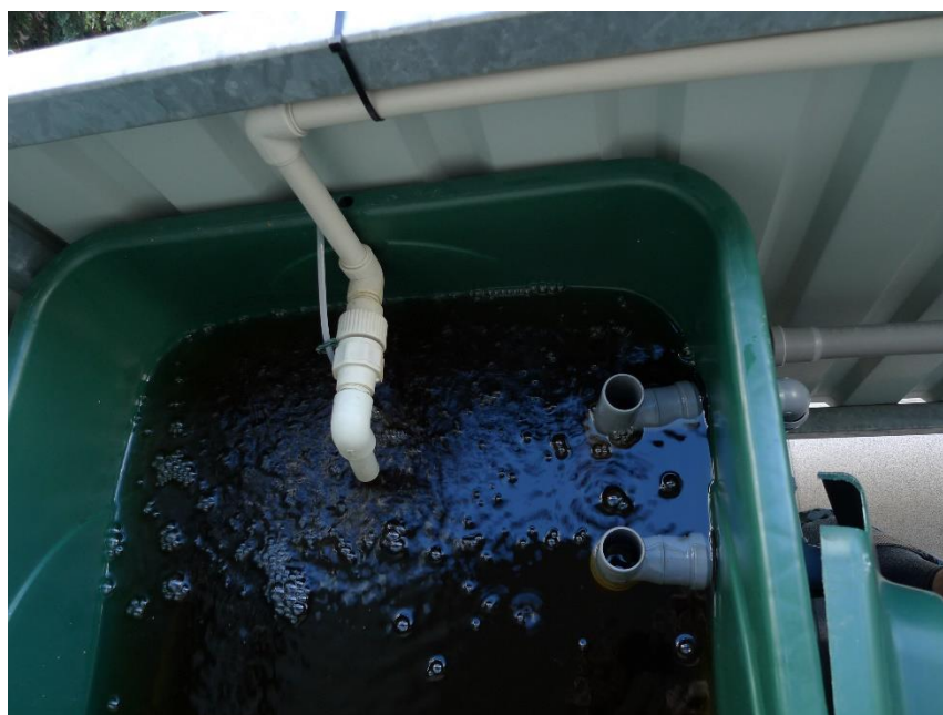
Obr. č. 21: Výpust a přítok (vlastní foto)
