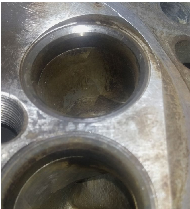
Obr. 40 Kritické místo kolem sedla ventilu - před úpravou
