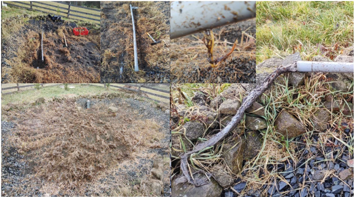
Obr. 16: kolmatace rozvodového potrubí kořenového filtru. Zdroj: archiv autora ze dne 24-26.02.2023
