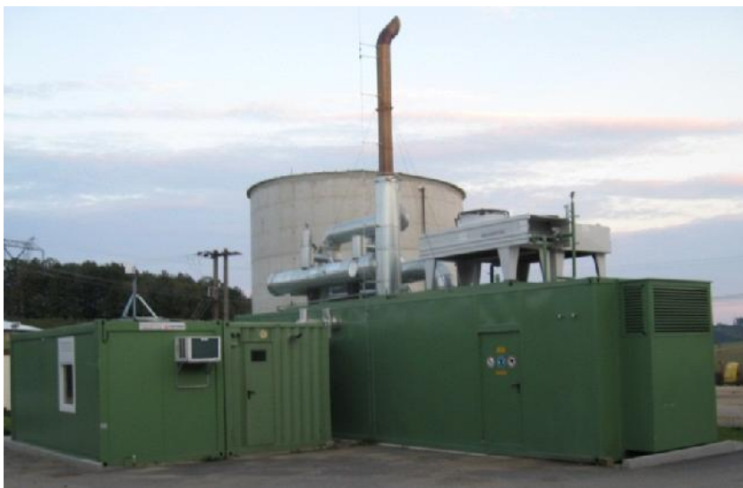
Obrázek 9 – Kontejnery s kogenera ní jednotkou a velínem
