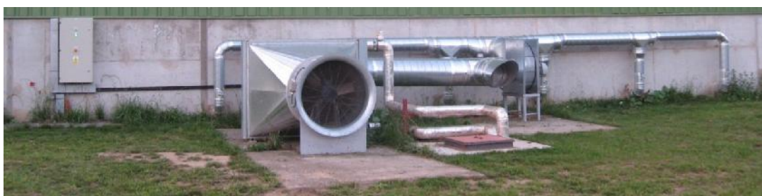
Obrázek 13 – Tepelný výměník a ventilátory
