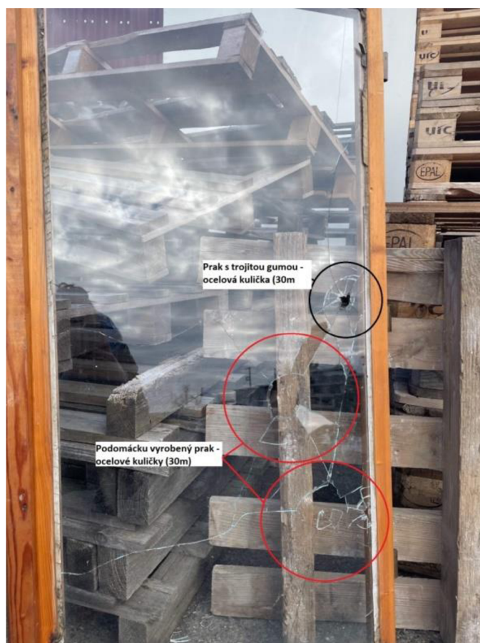
Obrázek 44 Penetrace okenní tabule - vlastní zdroj
