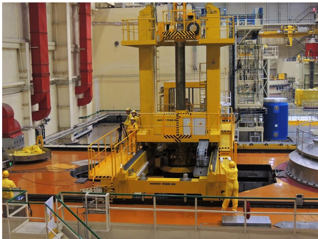
Obr. 6-1: Pohled na zavážecí stroj, který se nachází nad bazénem vyhořelého paliva, a na přípravy měření. JE Dukovany.
