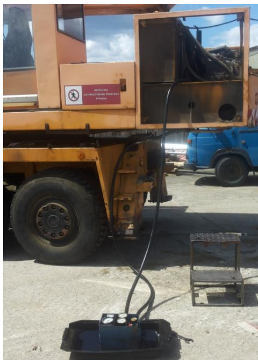
Obr. 24 - Zapojení měřidla při měření hydraulického obvodu zdvihu výložníku mezi SPV 23 a RS 32 [5]
