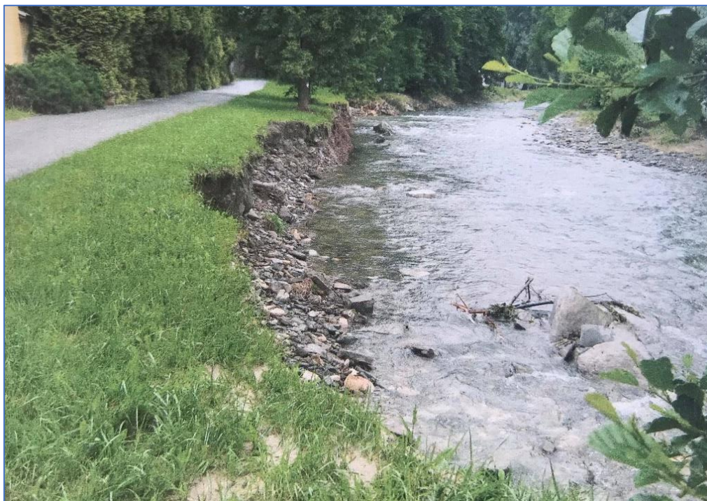
Obrázek 21 Vodní eroze po povodni u „zahradnictví“ v Kobylé n. Vidnavkou (SDH Kobylá, 2009)
