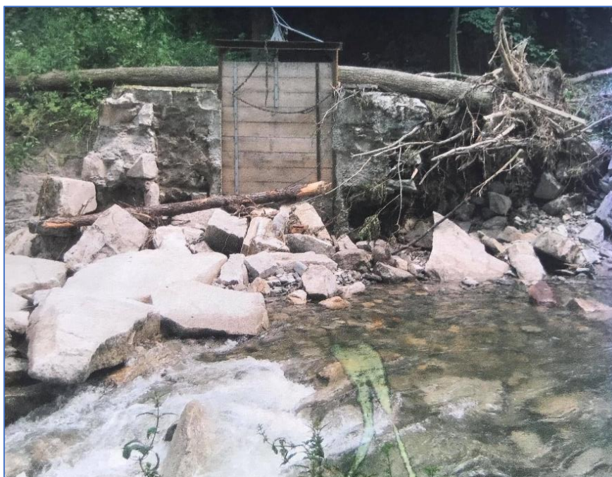
Obrázek 16 Zničené stavidlo v Kobylé. n. Vidnavkou (SDH Kobylá, 1997)
