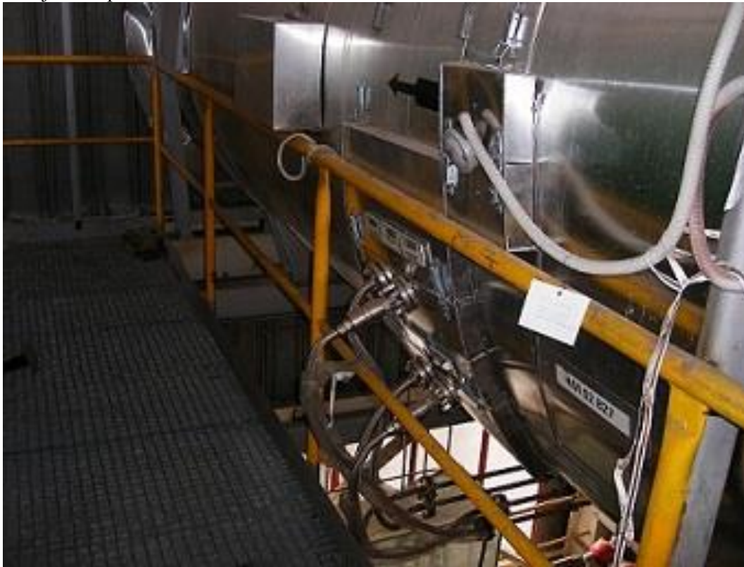
obr. č. 33 Nástřik \text{NH}_3 do spalinovodu před katalyzátorem – SCR Zdroj: autor práce
