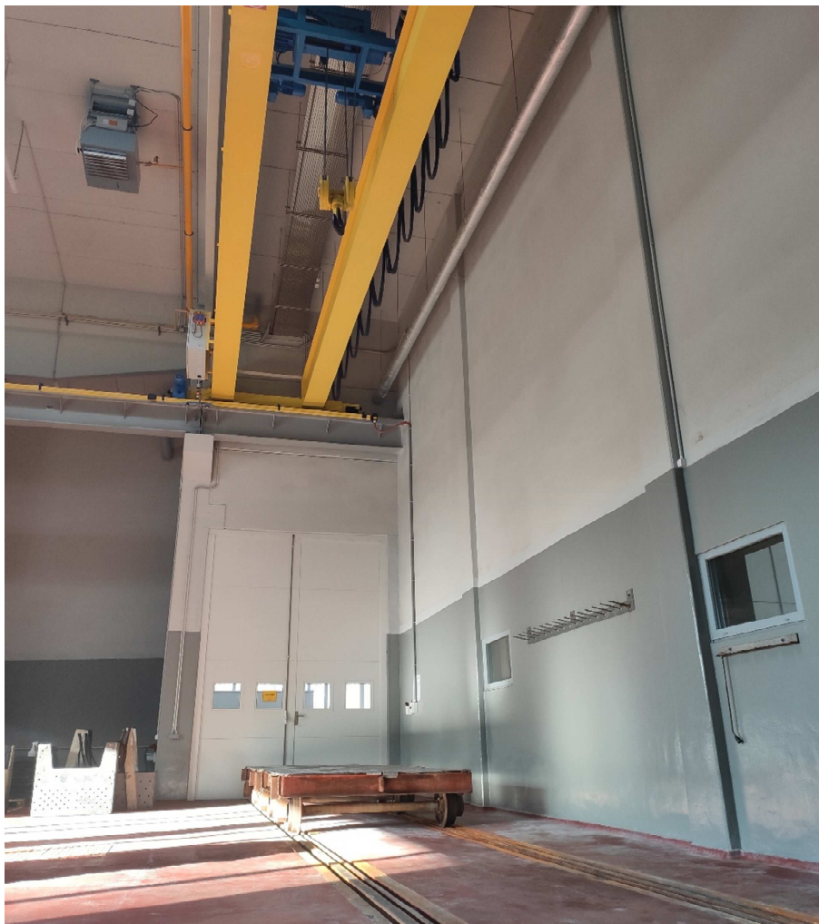
Obr. 19 Dopravní systém – kolej a mostový jeřáb
