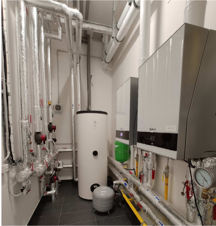
Obr. 21 Kotelna ve výrobní hale
