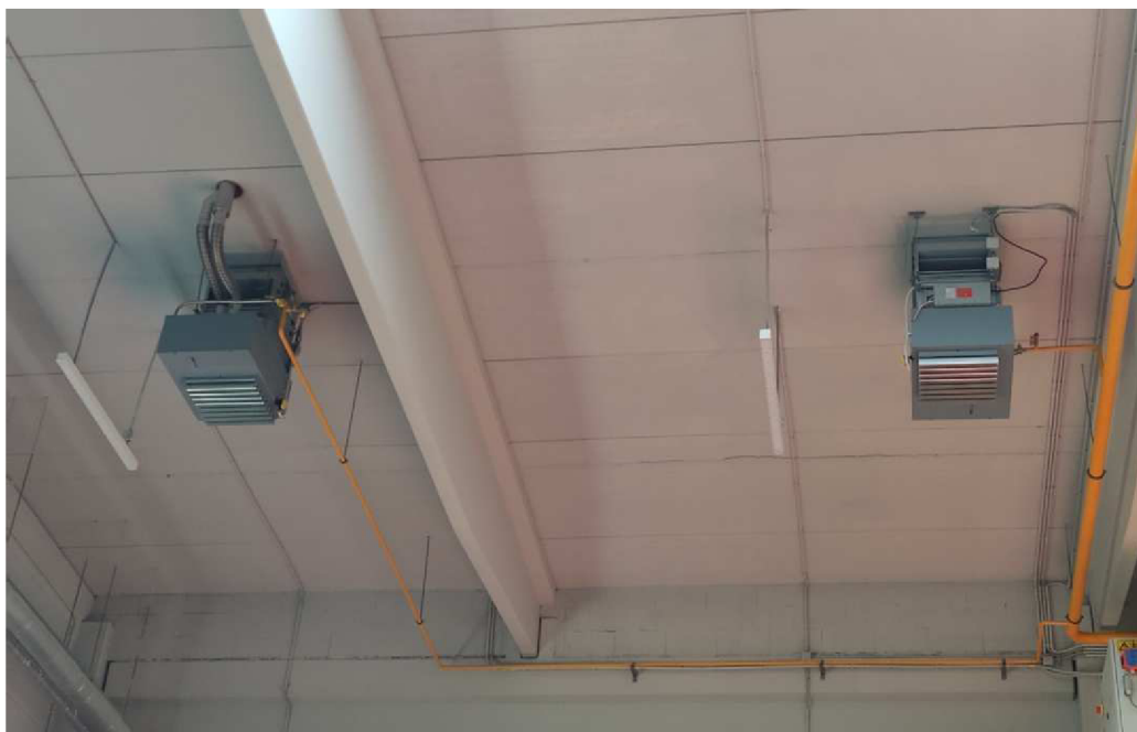
Obr. 20 Podstropní topné jednotky Sahara
