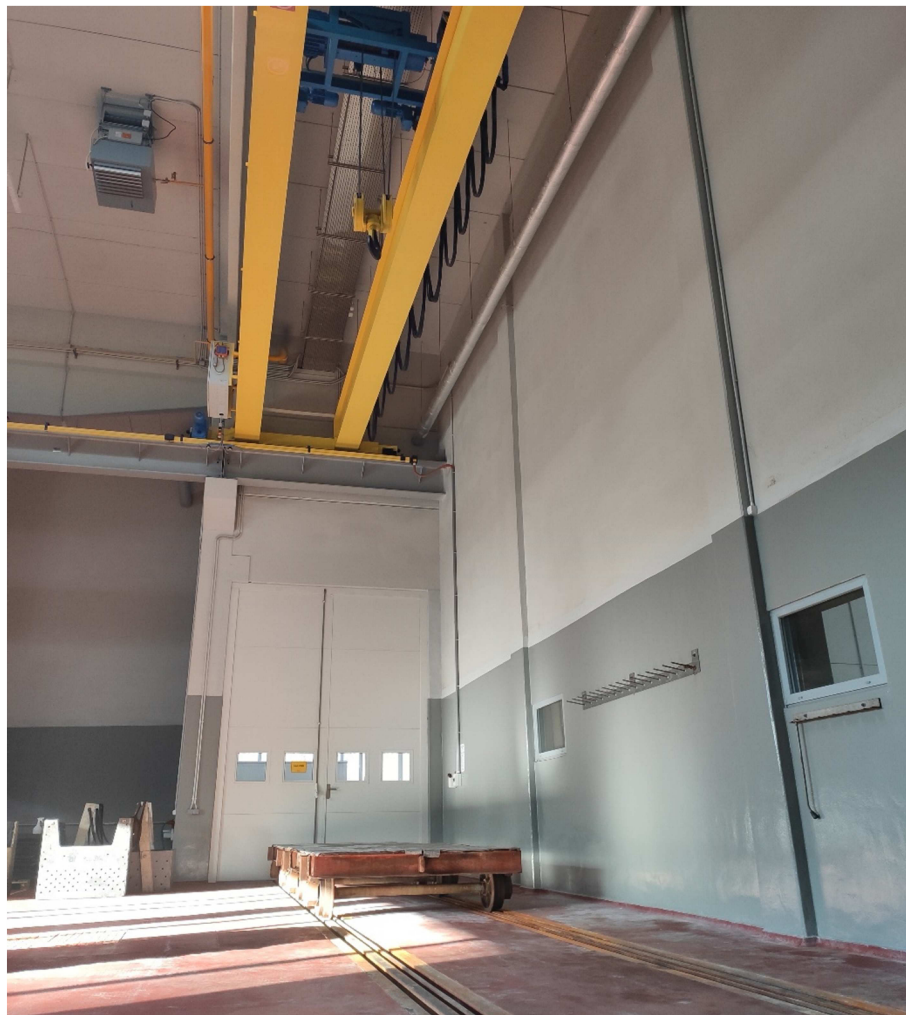
Obr. 19 Dopravní systém – kolej a mostový jeřáb
