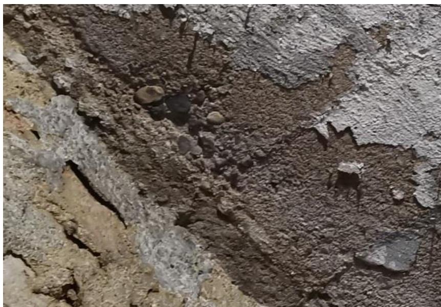
Obrázek 23: Viditelná struktura betonu stropní desky
