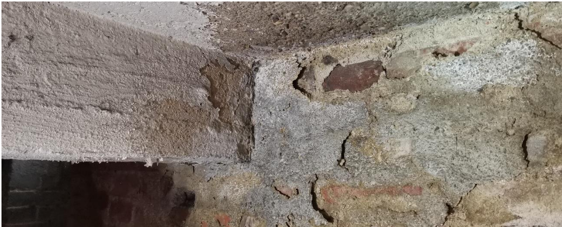
Obrázek 28: Degradace omítek u stropů v 1.PP
