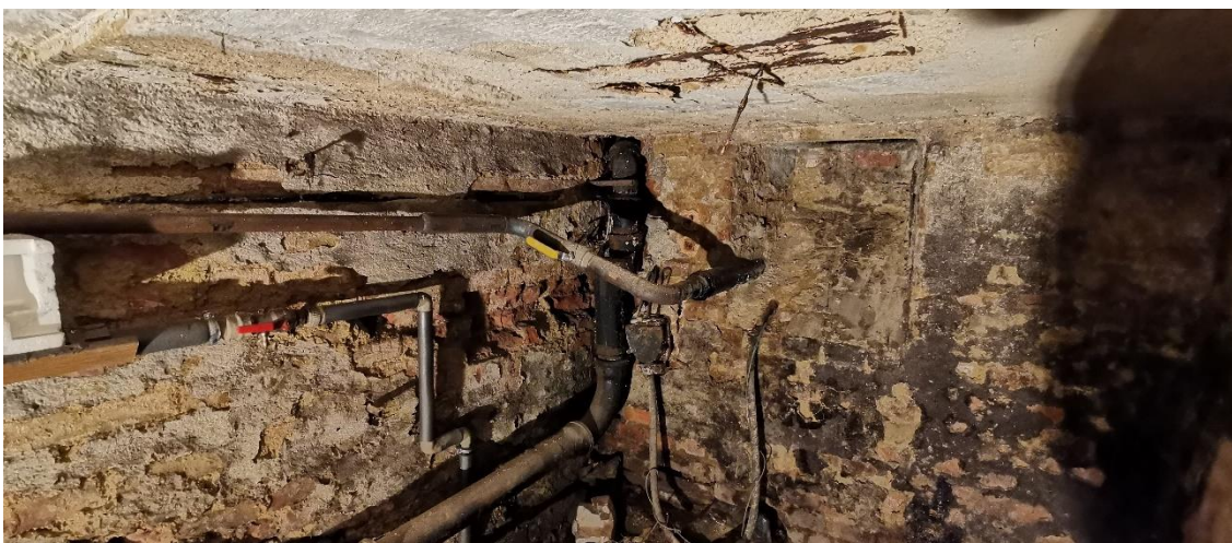
Obrázek 25: Přívod inženýrských sítí do objektu a korodující výztuž stropní desky
