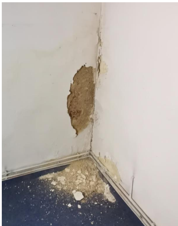
Obrázek 27: Vlhký kout v prostorách bývalé kuchyně
