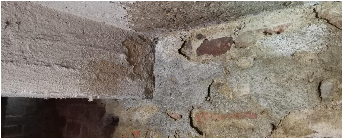
Obrázek 28: Degradace omítek u stropů v 1.PP
