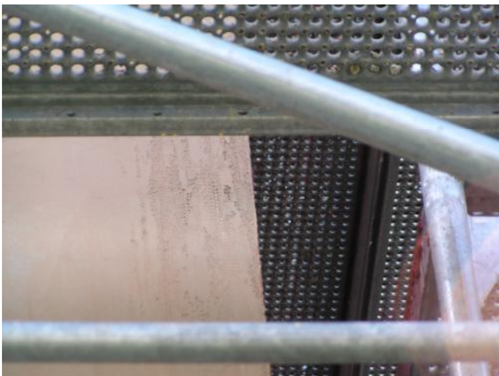
Obr. 17 Nesprávně provedená základní vrstva - viditelné struktura sítoviny, která není zapuštěná zcela do stěrkové vrstvy [102]
