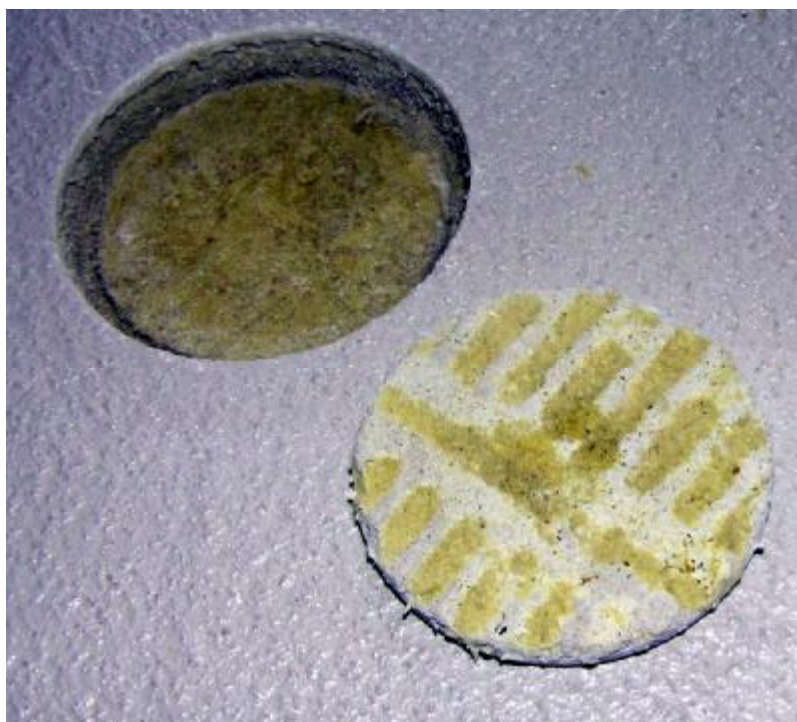
Obr. 49 Fotografie odtrhového terče, který se odtrhnul již při odvrtu před zkouškou [103]
