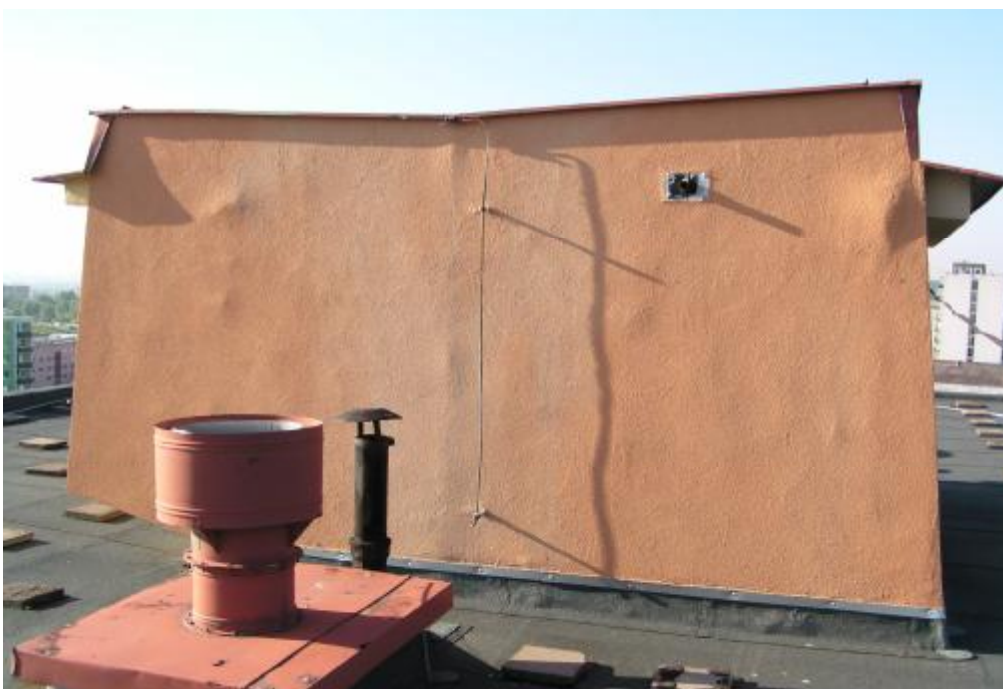
Obr. 20 Viditelná nízká soudržnost omítky s podkladem - na obrázku viditelné „boule“, ve kterých již došlo k oddělení omítky od podkladu a nedošlo k opadu [102]
