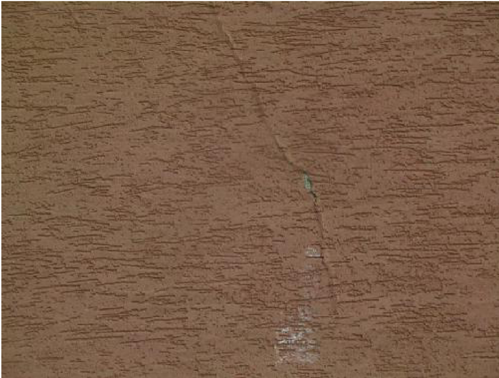
Obr. 19 Vliv nekvalitní penetrace, nesprávně provedené základní vrstvy a dle stop zasolení i nevhodného druhu použité omítky - vznik trhliny až do základní vrstvy a podstatné snížení životnosti a funkce systému [102]
