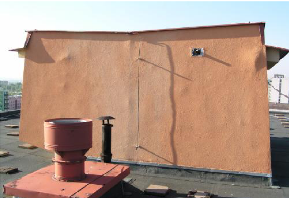
Obr. 20 Viditelná nízká soudržnost omítky s podkladem - na obrázku viditelné „boule“, ve kterých již došlo k oddělení omítky od podkladu a nedošlo k opadu [102]
