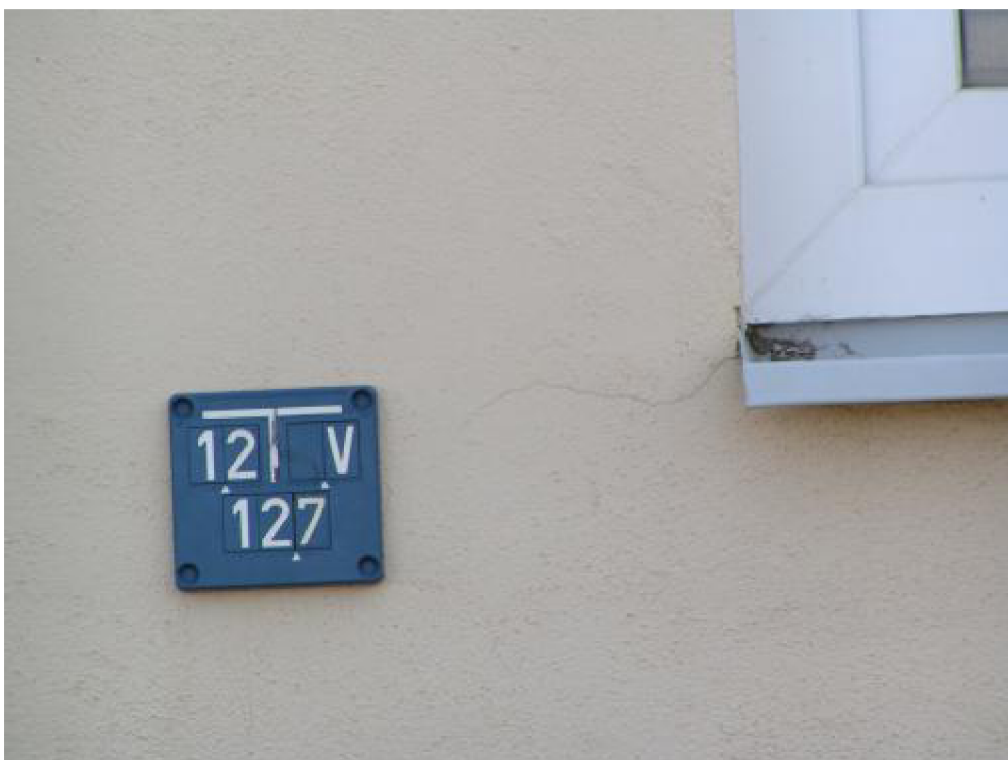
Obr. 18 Vliv nesprávně provedeného vyztužení okolí rohu otvoru v základní vrstvě - vznik diagonální trhlin, které snižuje životnost systému [102]
