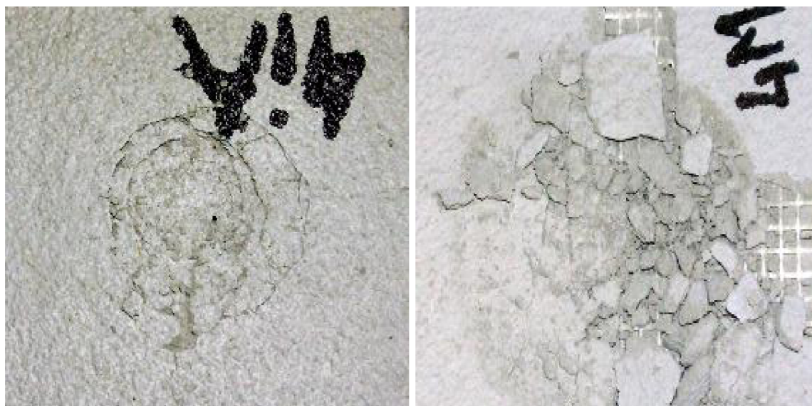
Obr. 52 Vzorky po provedení zkoušky odolnosti proti rázu - vlevo vzorek s poškozením „popraskáním“, vpravo vzorek s poškozením „destrukce, viditelná síť, opad“ [103]
