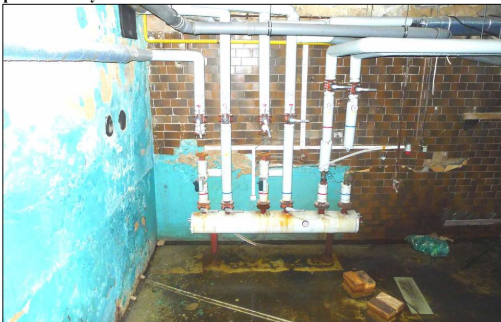
Obr. č. 25: Úroveň hladiny podzemní vody pronikající do objektu porušenou hydroizolací
