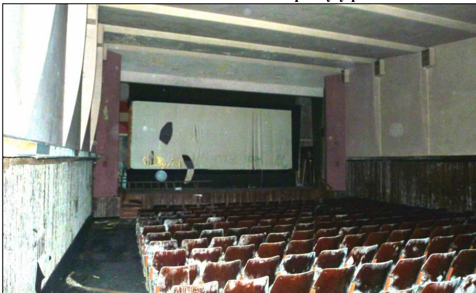
Obr. č. 24: Mobiliář i dřevěné obložení stěn pokryty plísní
