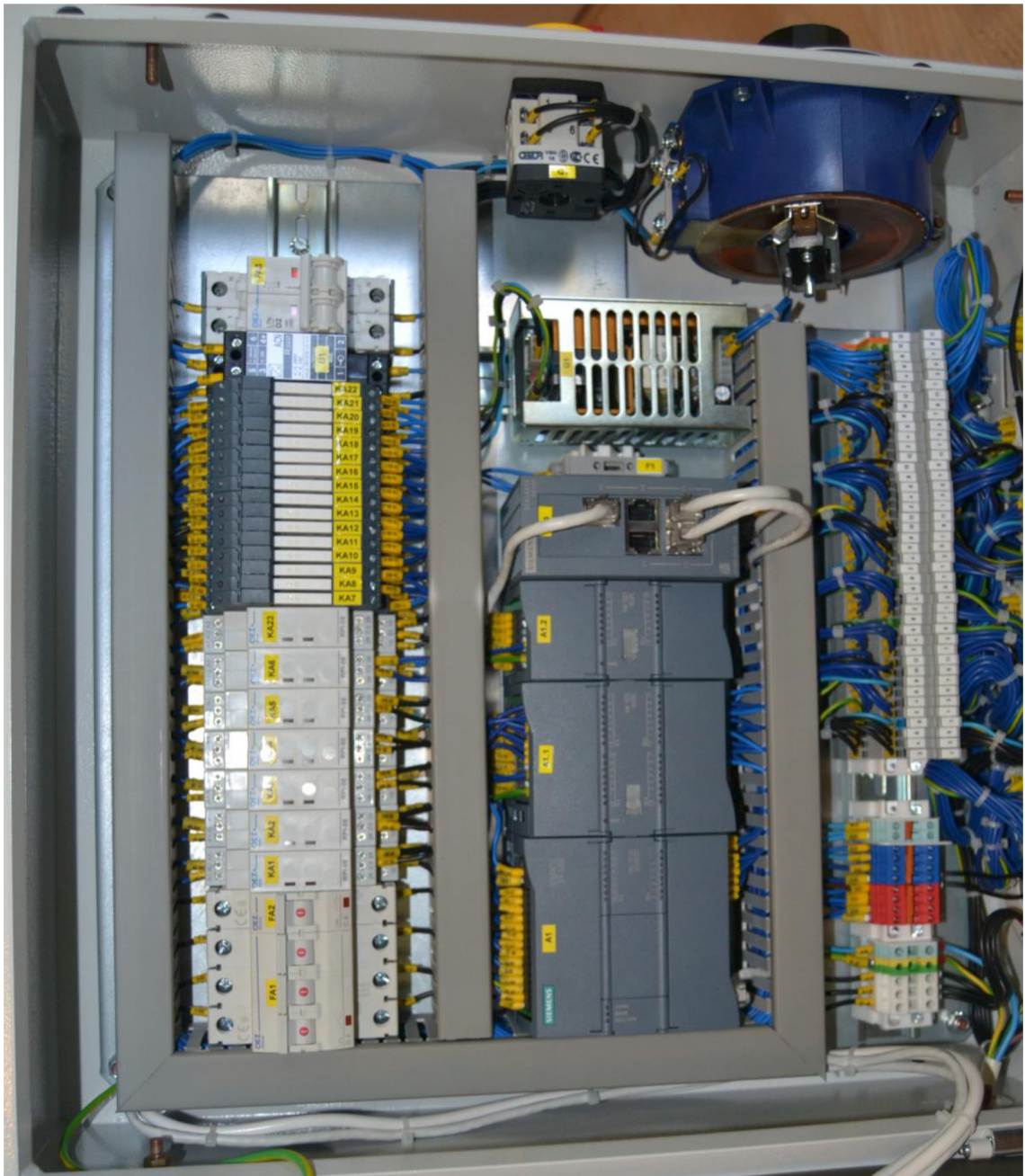
Obrázek 47 - Pohled na osazenou montážní desku
