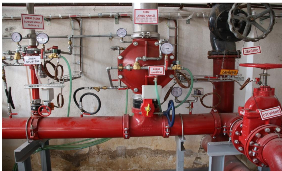
Obrázek 4 Ventilová stanice sprejového SHZ, zdroj: foto autor
