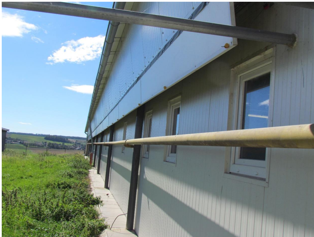
Obrázek 3.8: Venkovní ventilace vedená přes střechu do haly
