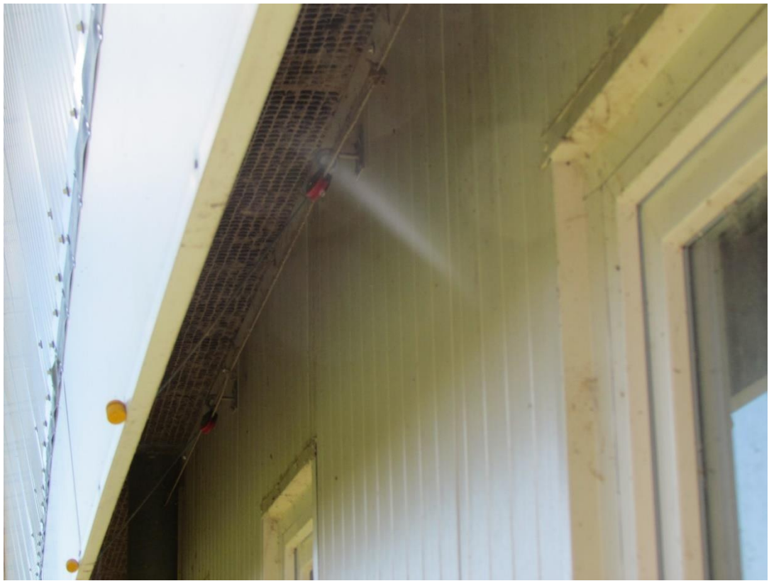
Obrázek 3.9: Venkovní ventilační mřížky
