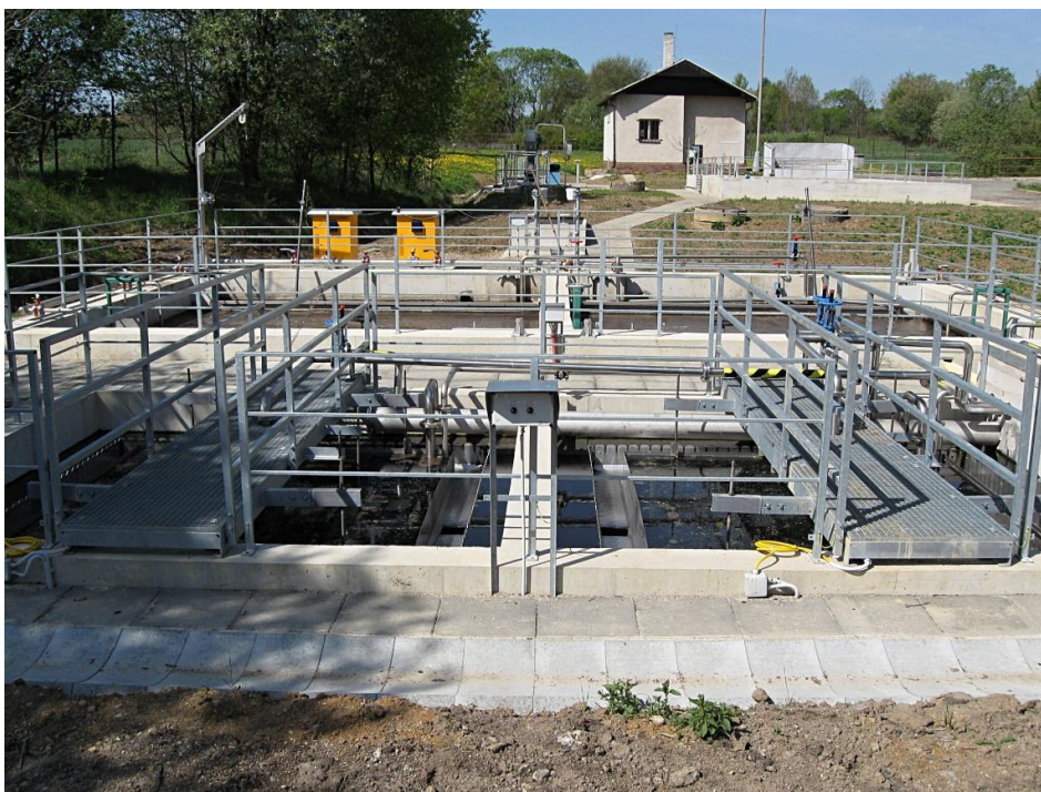
Obr. 1 - ČOV Vranov - Břasy ve zkušebním provozu 6.5.2011
