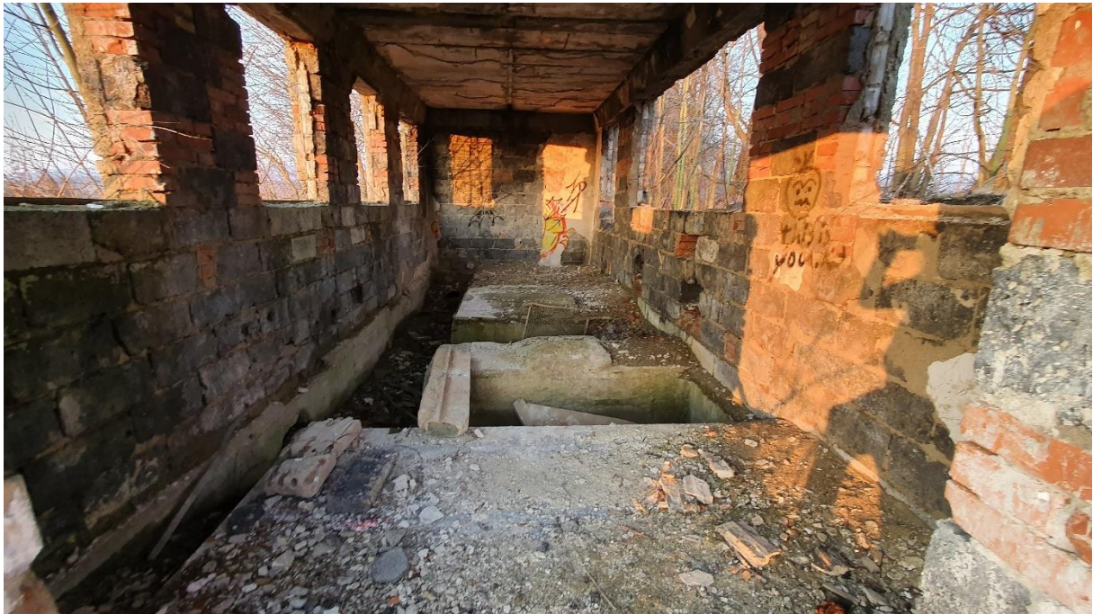
Foto č. 23: Vnitřní prostor stanice pro dvě velkokapacitní čerpadla (Zdroj: Vlastní archiv)
