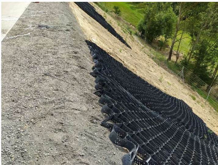
Obrázek 43: Chybně provedená instalace geobuňek (Kozák, 2021)
